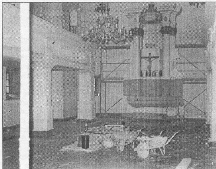
↑ AZ I. KER. EVANGÉLIKUS TEMPLOM FELÚJÍTÁS ALATT.
